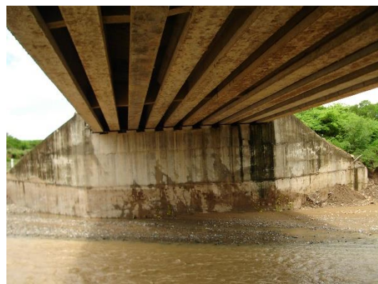
Figura 4.4, daño de desplome: nivel 1 (mala o defectuosa).
