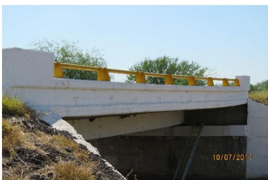
Figura 4.6, daño de flecha: Nivel 2 (regular)
