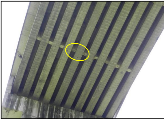
Figura 5.5-13 Vista general del daño en diafragmas.
