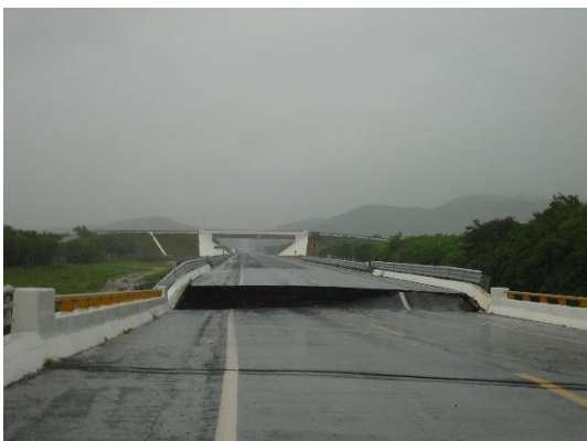
Figura 4.3, daño de hundimiento: nivel 1 (mala o defectuosa).
