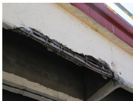
Figura 4.8, daño de impacto nivel 1 (mala o defectuosa)
