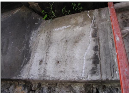
Figura 5.5-15 Vista general del daño en estribo.
