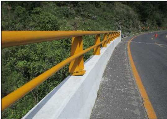
Figura 5.5-5 Vista general del daño en parapeto.
