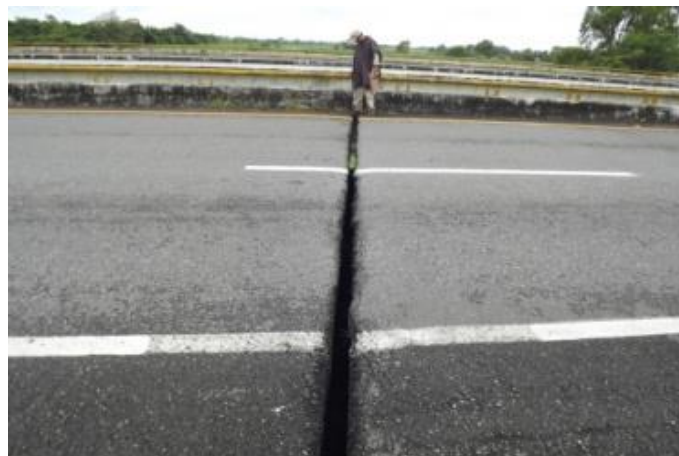
Figura 6.5-14. Inspección visual del estado de las juntas
