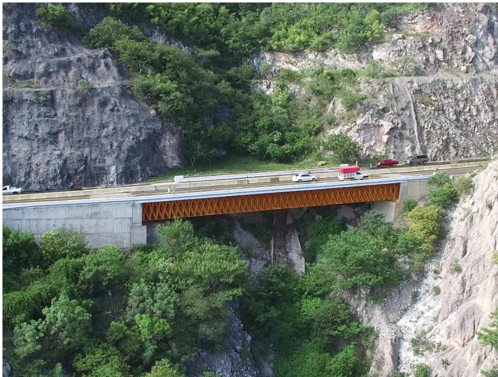
Figura 32. Ejemplo de puente con alineamiento vertical en tangente con pendiente (Puente la Huaracha)
