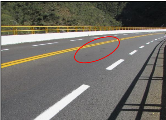
Figura 5.5-7 Vista general del daño en superficie de rodadura.
