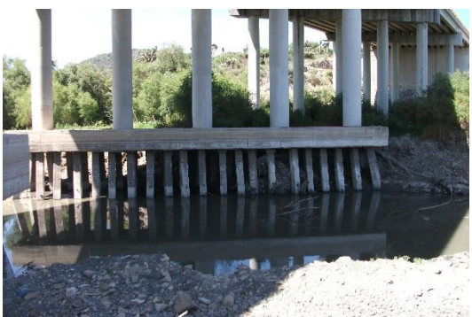
Figura 4.5, daño por Socavación Nivel 1 (mala o defectuosa)
