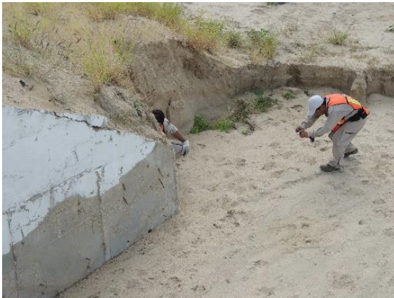
Figura 6.5-21. Documentación fotográfica de daños en subestructura
