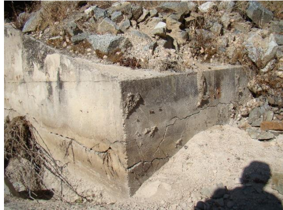
Figura 6.5-26. Registro fotográfico de grietas en cimentación
