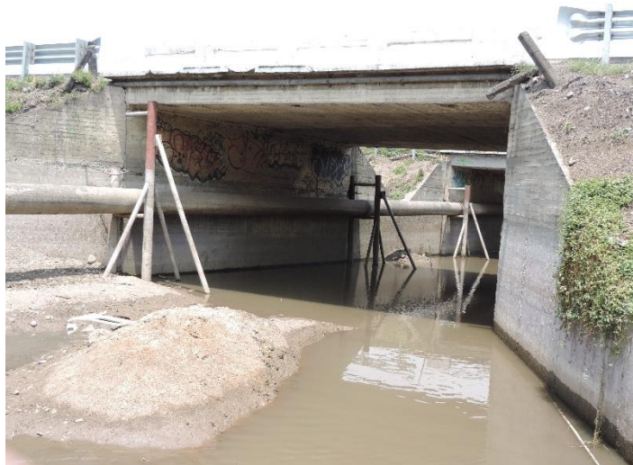
Figura 6.5-15. Servicios públicos adosados a la estructura.
