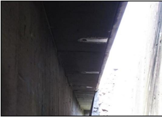
Figura 5.5-11 Vista general del daño en drenes.
