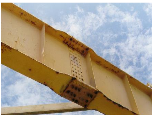
Figura 4.7, daño de corrosión nivel 2 (regular)
