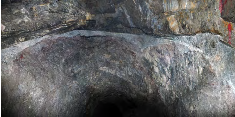
Figura 6.21. Vista de una falla importante en la bóveda de un túnel.
