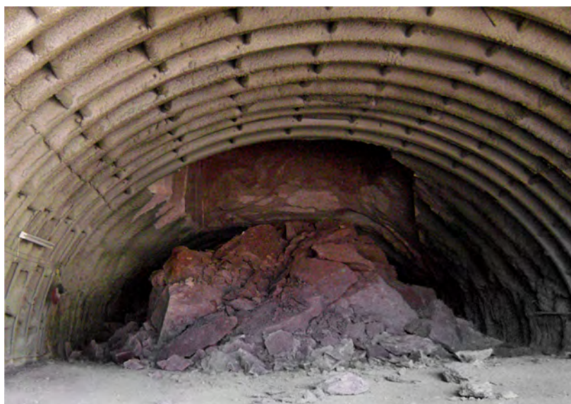
Figura 6.16. Caído súbito de un bloque en el túnel Lambederos. Autopista Durango-Mazatlán, abril del 2010.
