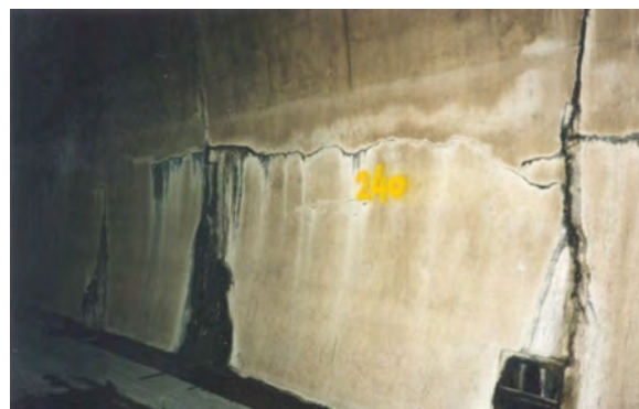
Figura 6.20. Rotura de la parte baja de un revestimiento. Tomada de Heidkamp y Katz, 2004.
