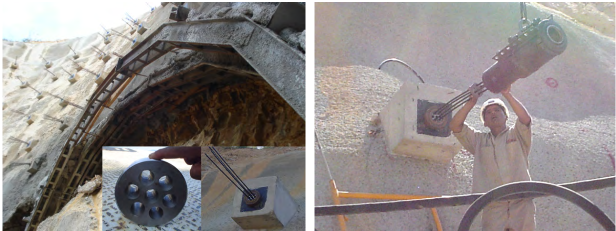
Figura 5.39. Anclas de tensión con dados de concreto.
