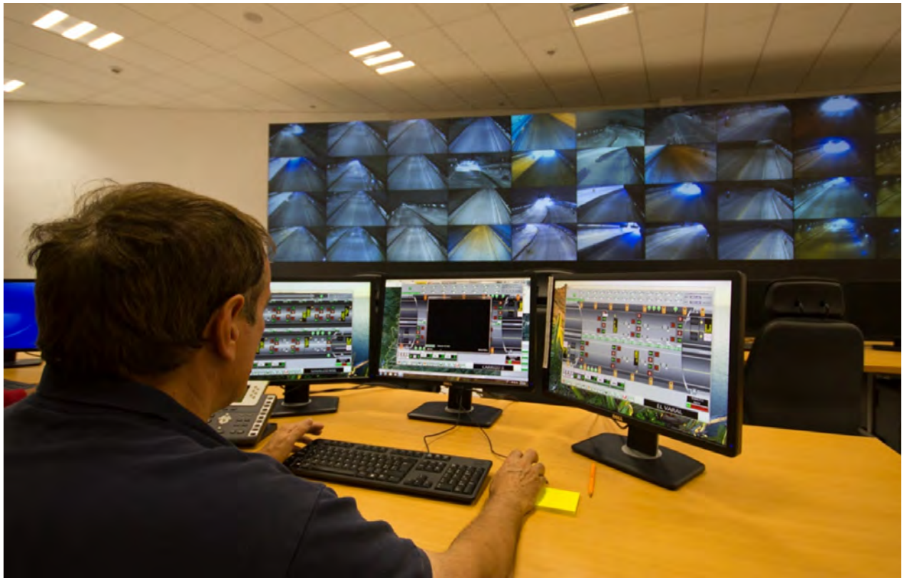
Centro de Control, Túneles Carretera Durango - Mazatlán
