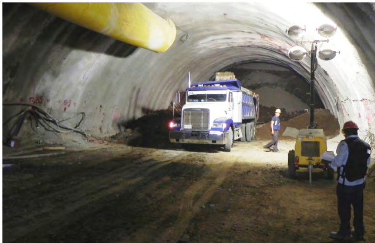
Figura 18.46. Iluminación del frente de excavación donde no se presenta deslumbramiento ni brillo excesivo.
