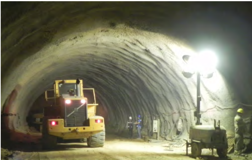
Figura 18.12. Sistema de iluminación de emergencia mediante torre de luz.
