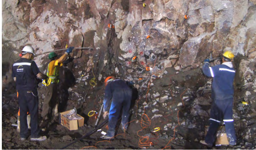
Figura 18.42. Supervisión de la colocación de explosivo (ANFO) en el frente de excavación.
