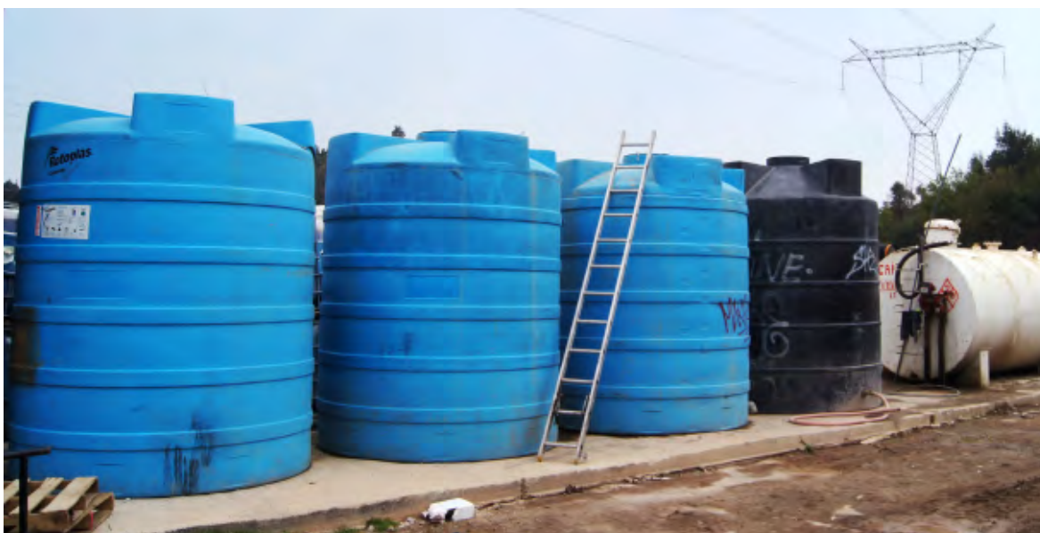
Figura 18.22. Almacén de depósitos de agua previsto para el desarrollo de los trabajos en la obra.
