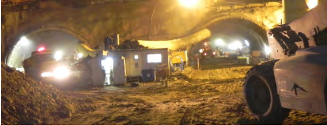
Figura 18.11. El portal deberá tener mayor iluminación durante el desarrollo de trabajos nocturnos.
