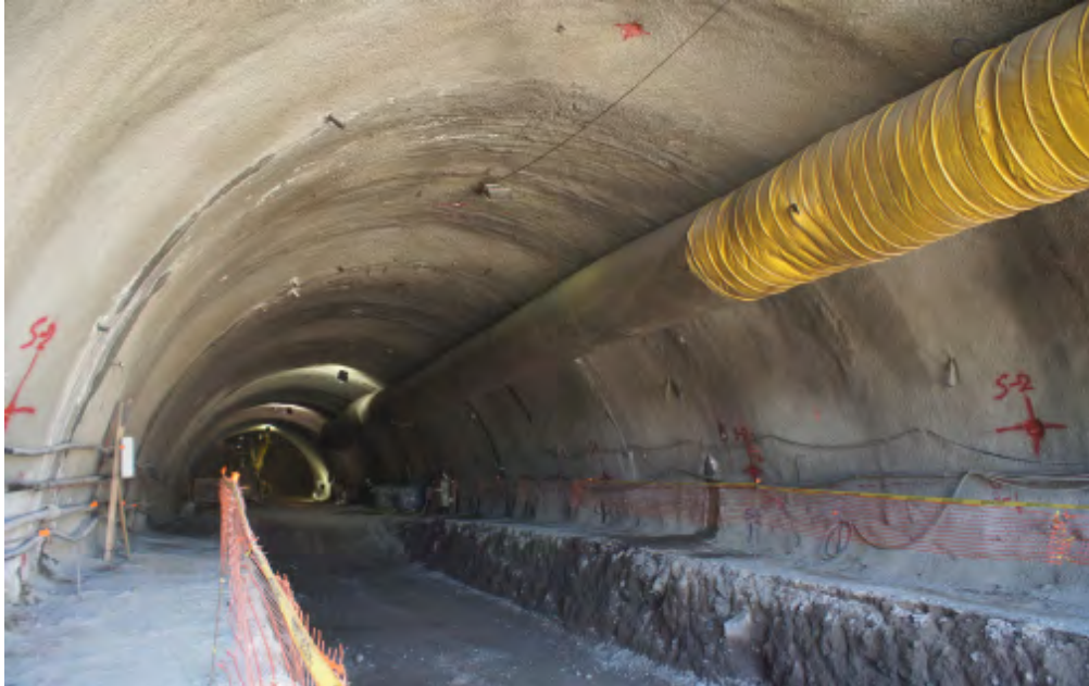
Figura 18.14. Sistema de ventilación a lo largo del túnel, extendida cerca del frente de excavación.
