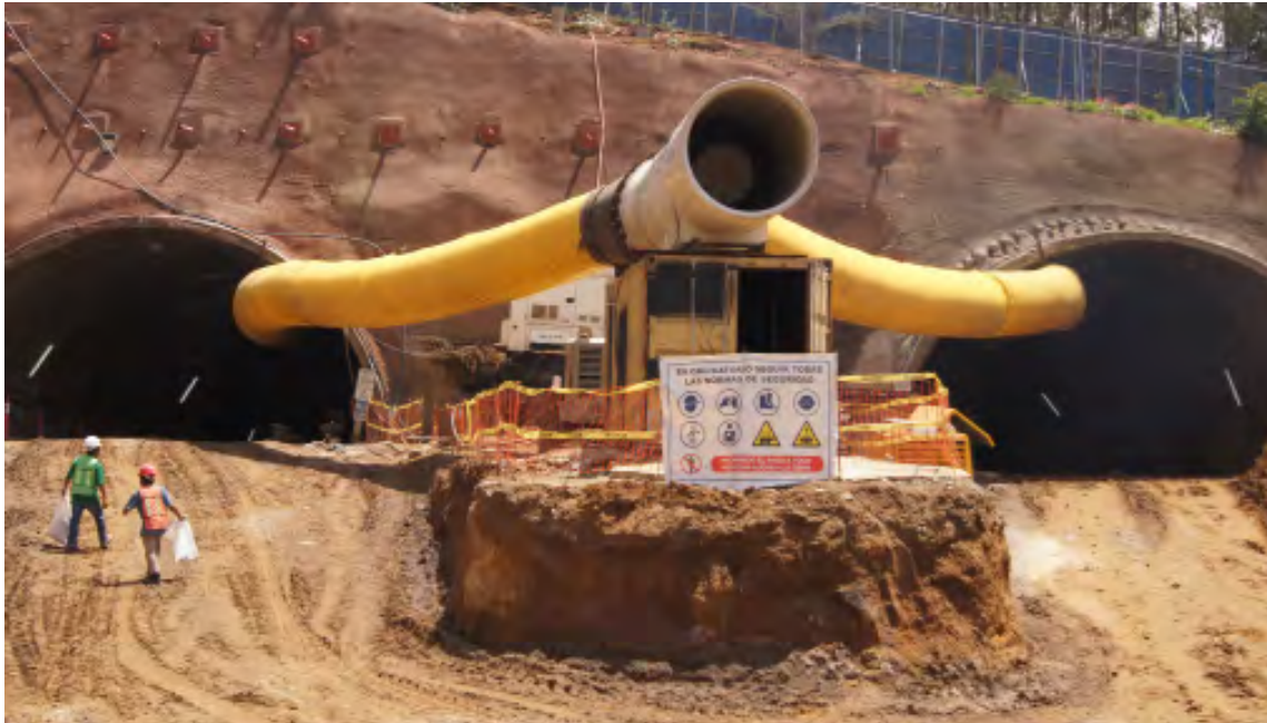
Figura 18.13. Sistema de generación de aire para ventilación del interior del túnel.
