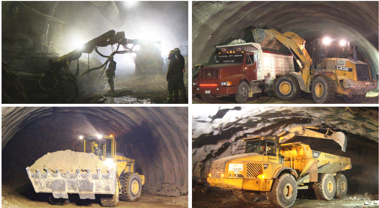
Figura 18.48. Toda la maquinaria pesada usa como combustible diesel, generando CO 2 al interior del túnel.
