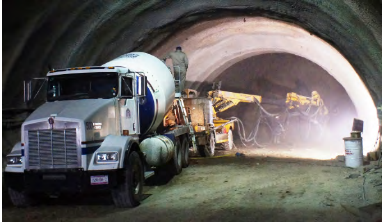
Figura 18.47. Generación de polvo debido al lanzado de concreto en el frente de excavación.
