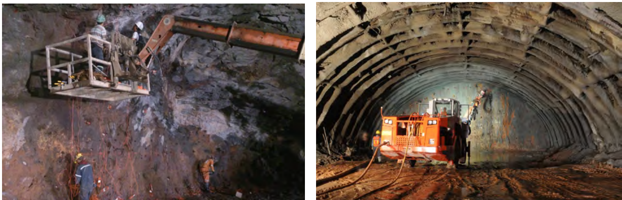
Figura 13.10. Frente de excavación en el que se efectúan trabajos de barrenación para preparar una voladura.
