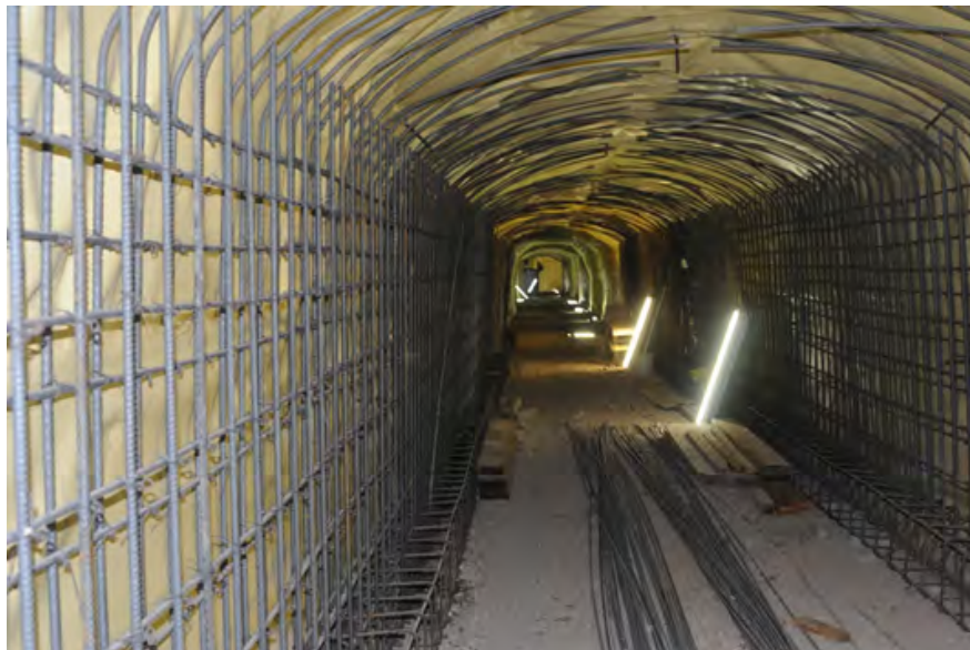
Figura 12.6. Membrana impermeabilizante detrás del revestimiento definitivo.
