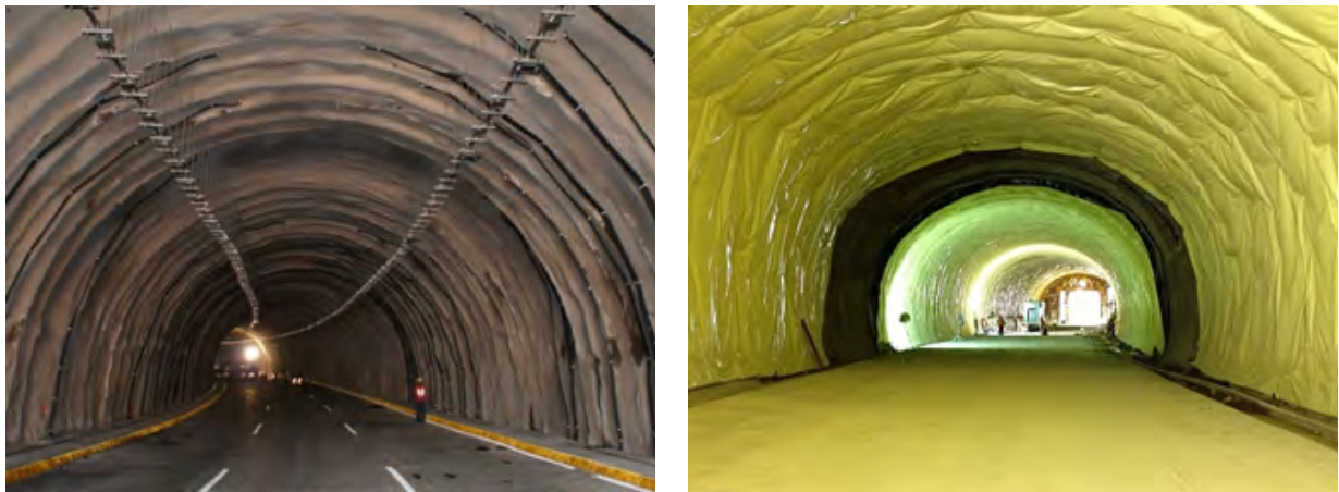
Figura 12.1. y 12.2. Túnel sin sistema de impermeabilización y túnel con geotextil y geomembrana.
