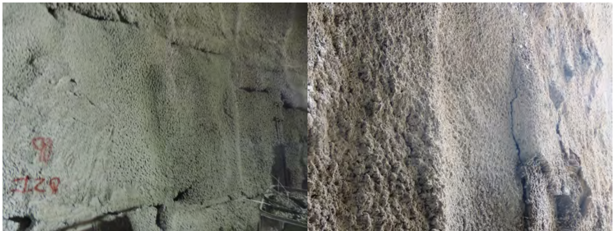
Figura 11.18. Defectos de aplicación concreto lanzado.
