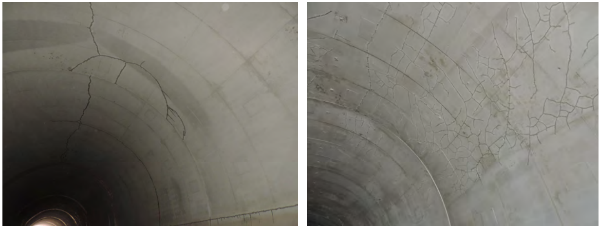
Figura 11.15. Presencia de fisuras, revestimiento concreto simple.
