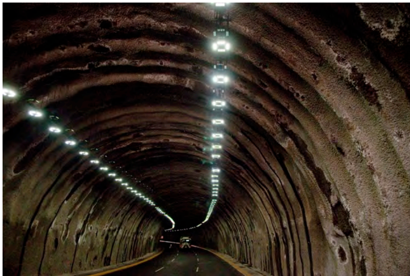
Figura 11.17. Efecto de “costillas” en el revestimiento definitivo de concreto lanzado. Túneles Supervía Poniente, Ciudad de México.
