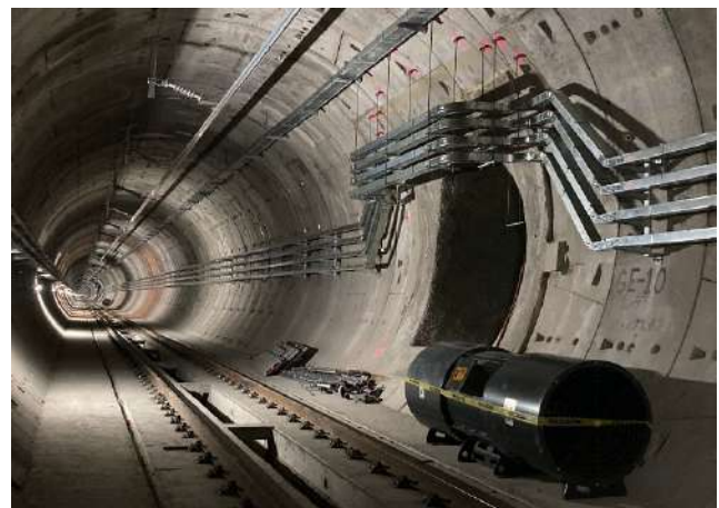
Foto: Canalizaciones, vía y catenaria en túnel, en el estado de México
