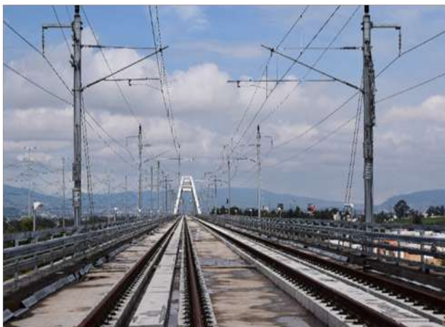
Foto: Vía y Catenaria en Viaducto 1, en el estado de México
