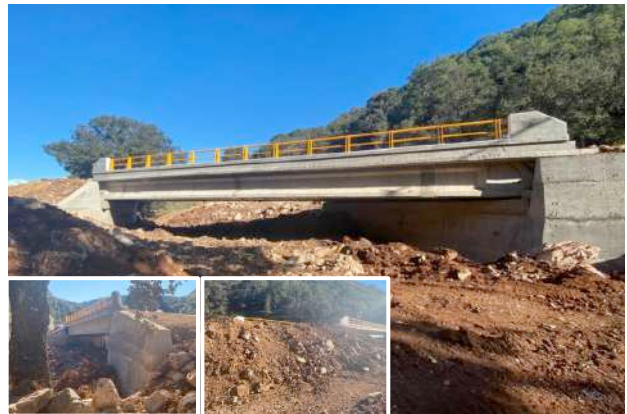
Foto: Puente ubicado en el km 14+800, sobre el camino San Miguel Huautla – San Miguel Chichahua, en Oaxaca.
