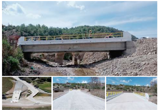
Foto: Puente ubicado en el km 6+500, sobre el camino E.C. (Yucudaa- San Pedro Teposcolula) – San Vicente, en Oaxaca.
