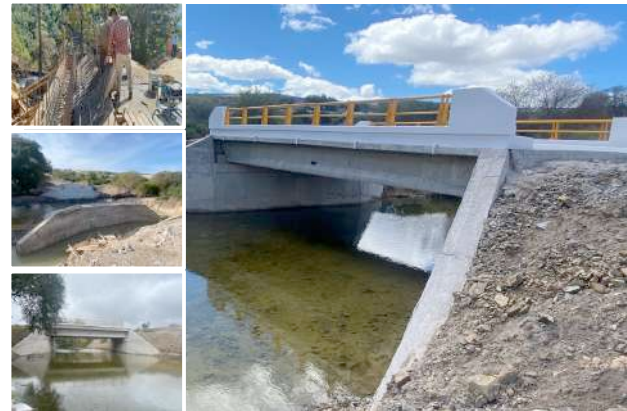
Foto: Puente ubicado en el km 6+000, sobre el camino Santiago Tepetlapa – San Cristóbal Suchixtlahuaca, en Oaxaca.
