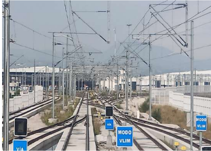
Foto: Pruebas locales de Señalización en Talleres y Cocheras, en el estado de México
