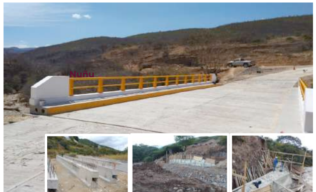
Foto: Puente ubicado en el km 4+500, sobre el camino E.C. (San Bartolomé Yucuañe - San Juan Teita) - Sta. María Tataltepec, en Oaxaca.
