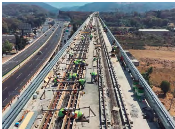
Foto. Vía y Catenaria, Tren Interurbano México-Toluca.
